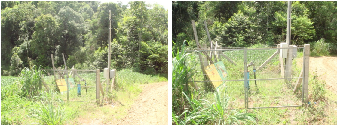
Figura 8.25 – Poço profundo – linha Água limpa
