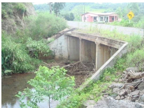
Figura 9.6 – Ponto de inundação – Saída para Jardinópolis
