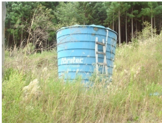
Figura 8.4 – Reservatório “A” fibra de vidro de 20m 3
