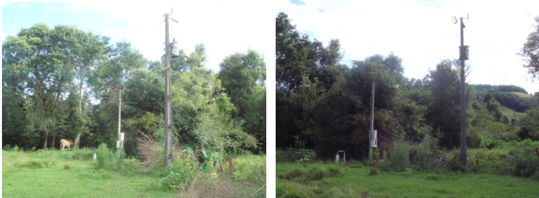
Figura 8.9 – Poço profundo – linha Flor
