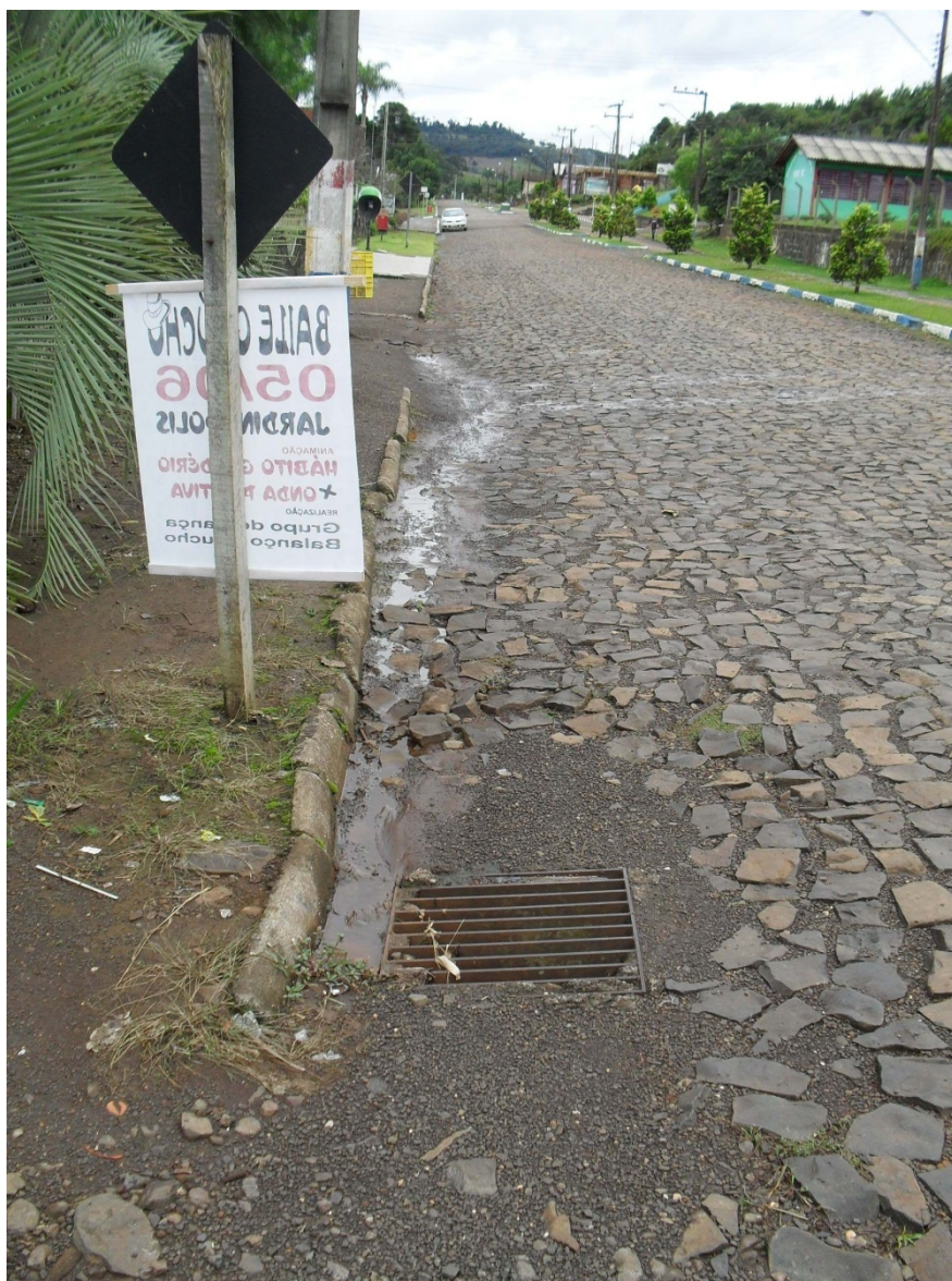
Figura 9.8– Boca de Lobo
