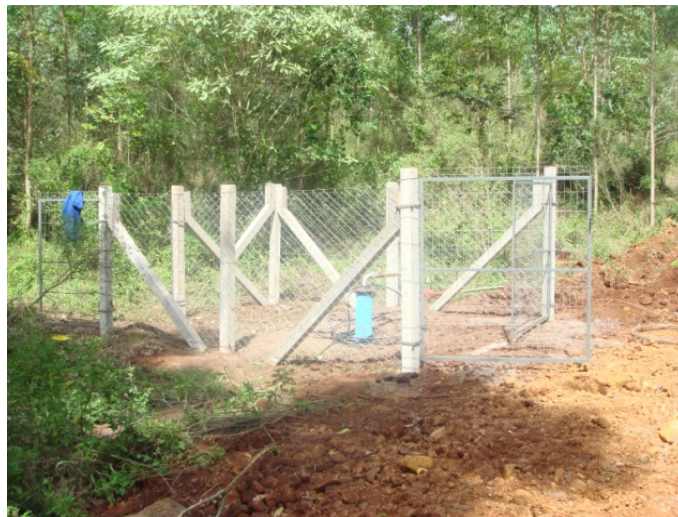
Figura 8.21 – Poço profundo – linha Santo Antônio
