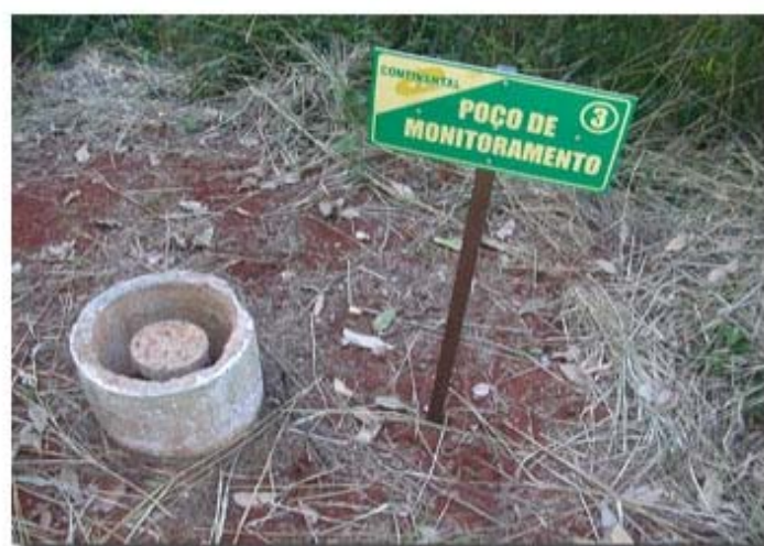
Figura 10.14 -Aterro Sanitário da empresa CONTINENTAL na cidade de Xanxere – SC – Poço piezométrico
