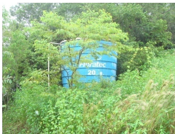
Figura 8.5 – Reservatório “B” fibra de vidro de 20m 3
